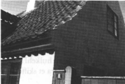
Tag forsynet med opskalkning
